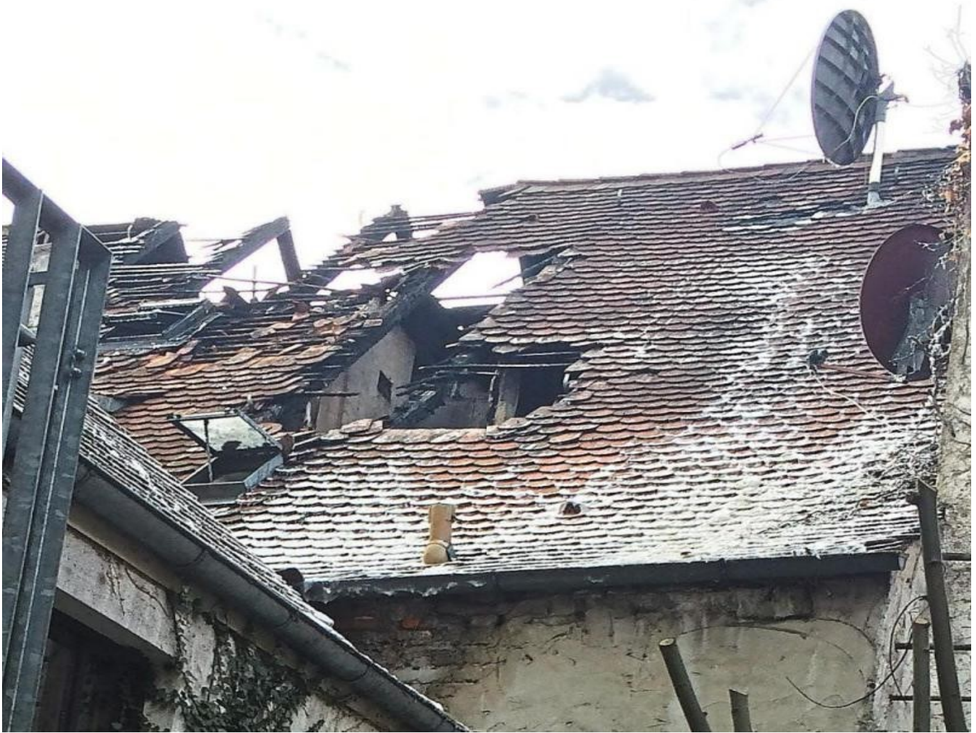
Das Dach wurde durch die Flammen und Löscharbeiten ganz erheblich beschädigt.
